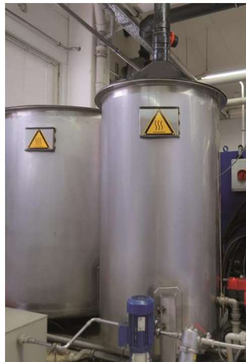
Anlage zur Waschwasseraufbereitung bei Schulte & Schmidt
